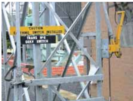
66kV Earth Switch
