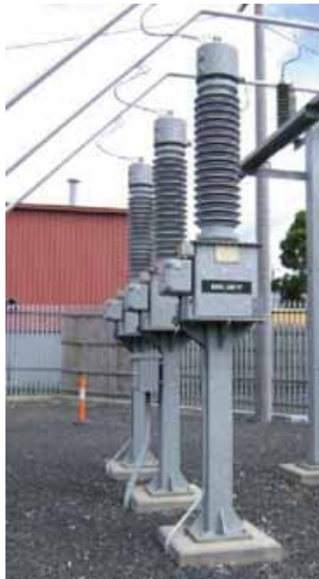
A 66kV VT
